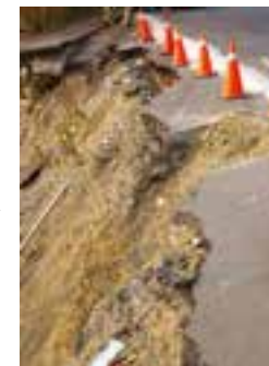
Osuwisko – to skutek zniszczenia pokrywy roślinnej na zboczach
