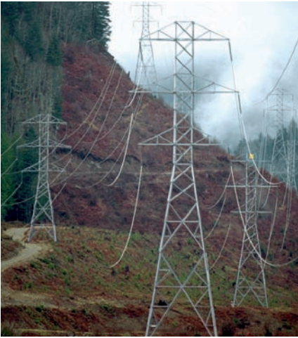
Опори ліній електропередачі
