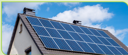
Мал. 120. Сонячні батареї на даху приватного будинку
