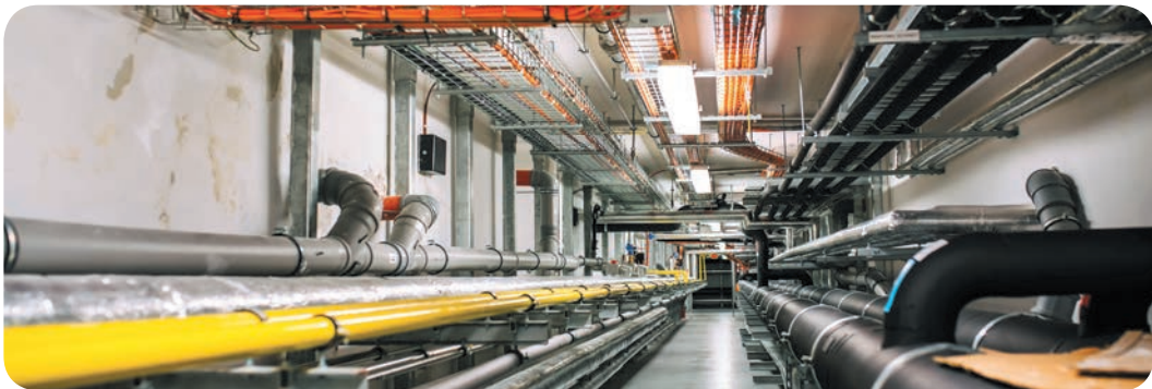
Технічний поверх багатоповерхівки
