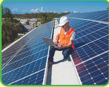
El ingeniero eléctrico en la planta de energía solar.
