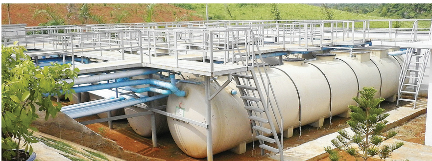
Рис. 44.6. Установки з очищення води закритого типу
