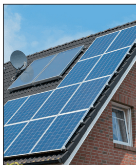
Fig. 38. Panouri solare pe acoperișul casei
