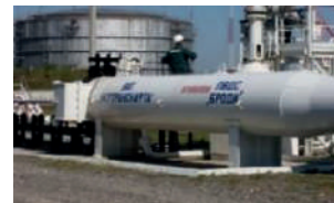
Іл. 43.11. Нафтоперекачувальна станція (Одеса – Броди)
